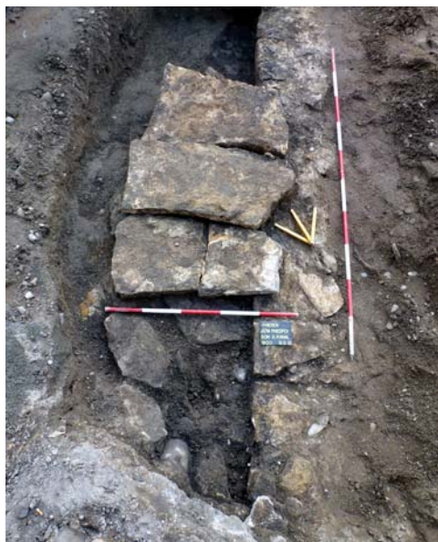
15 Pohled na odkrytý úsek jedné z větví kanalizační stoky částečně poškozené recentními zásahy v Mostní ulici (foto Z. Schenk)
